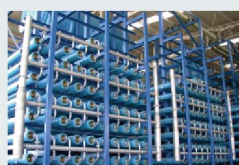
海水淡化和再生水
